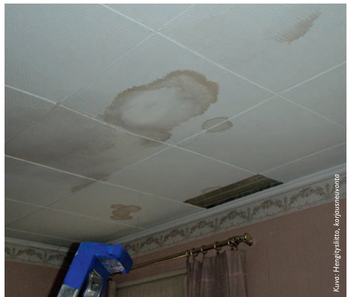
Kattovuodon aiheuttamia kosteusjälkiä välipohjassa.
